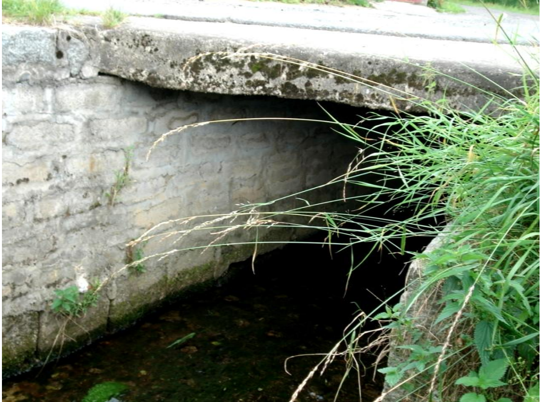
Fot. nr 7. Prawobrzeżny mur przyczółkowy od dolnej wody murowany z bloczków betonowych widoczne przy dnie lokalne ubytki materiału i spoin, korozja betonu
