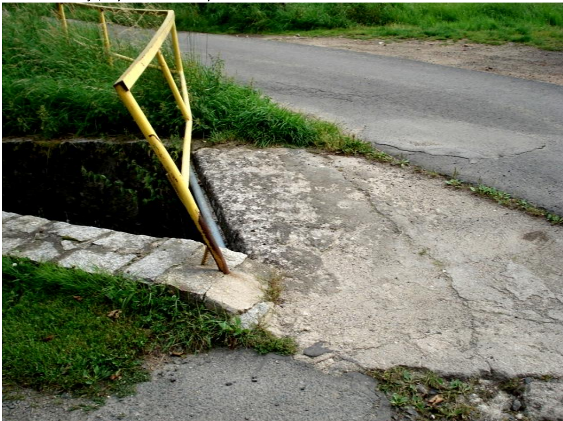
Fot. nr 4. Uszkodzenia płyty pomostowej – ubytki w strefie przykrawędziowej, spękania, wglębna korozja betonu. Uszkodzenia balustrady typu mechanicznego przez pojazdy samochodowe
