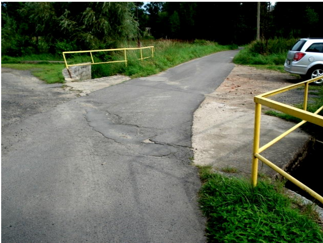
Fot. nr 2. Uszkodzenia nawierzchni jezdni – deformacje (zapadliny), ślady wykonanych napraw
