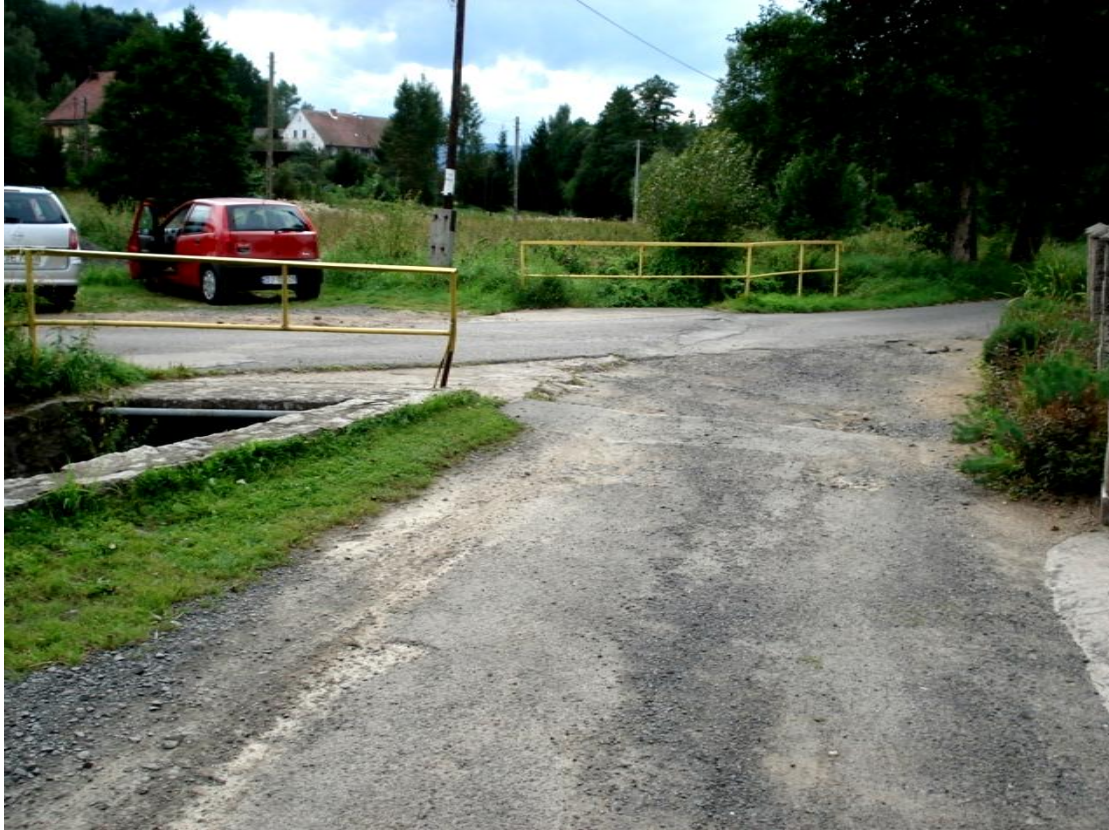
Fot. nr 3. Uszkodzenia nawierzchni bitumicznej jezdni na wjeździe drogi bocznej – prawie całkowita erozja, wykruszenia i ubytki
