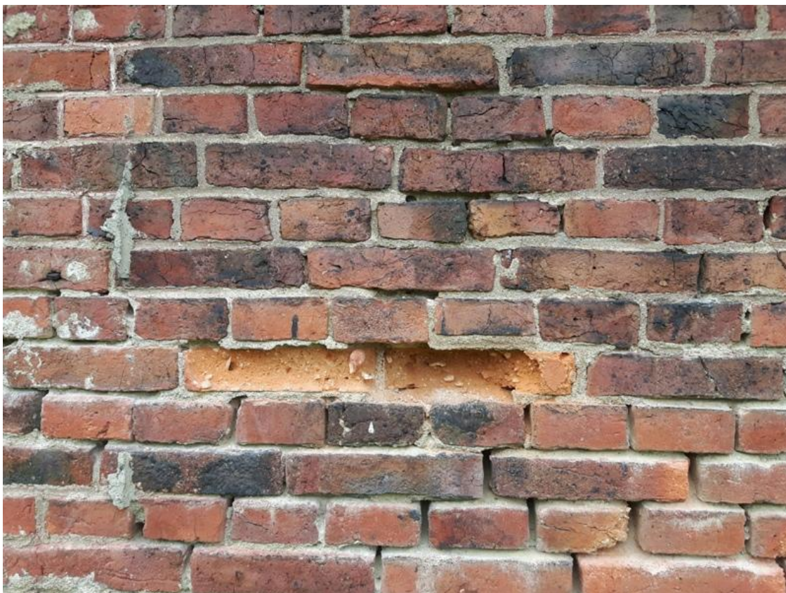
Fot. 5. Przykładowe uszkodzenia elewacji
