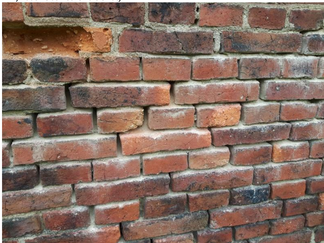
Fot. 6. Przykładowe uszkodzenia elewacji oraz stan spoin
