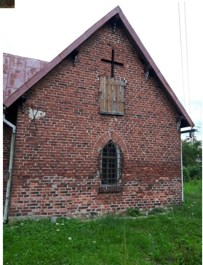
Fot. 4. Elewacja południowa – do odtworzenia również drzwiczki na strych
