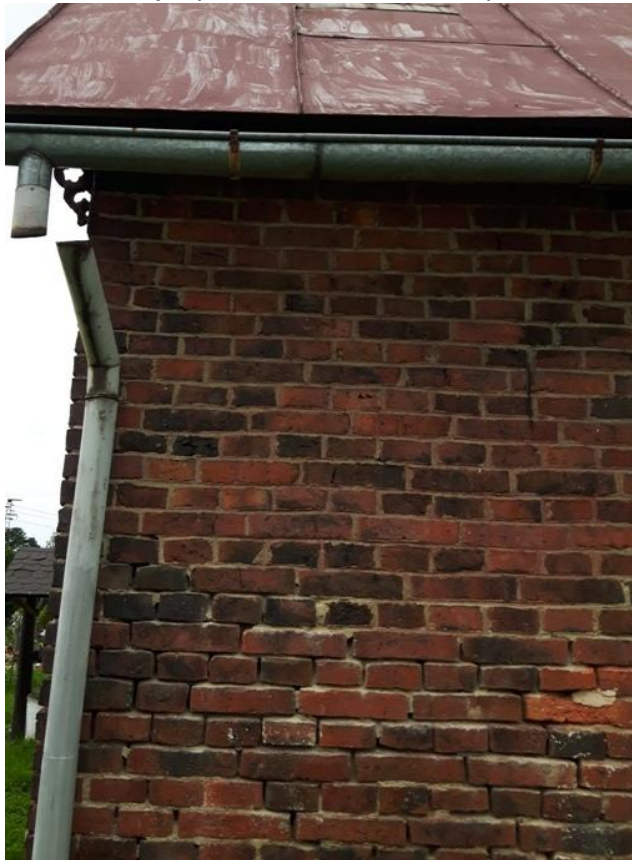
Fot.3. Elewacja tylna – widok na dach, orynnowanie oraz stan techniczny muru,
