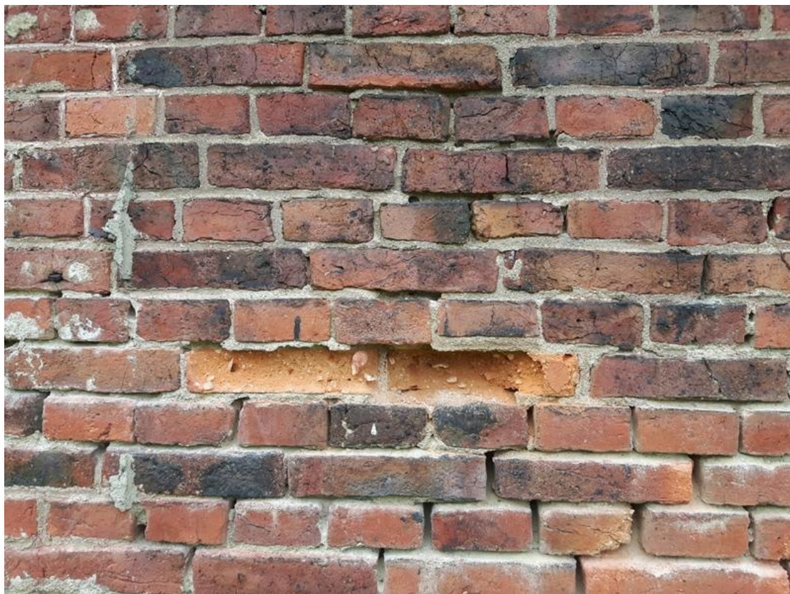
Fot. 5. Przykładowe uszkodzenia elewacji
